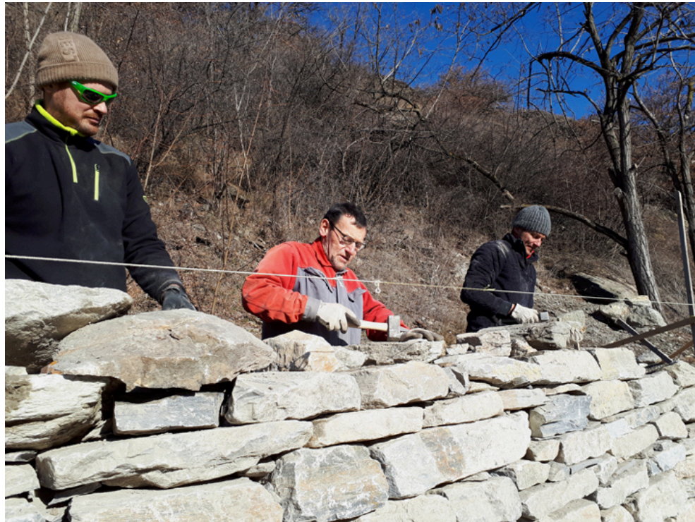
Ausbildungskurs in Châteauneuf. Martin Lutz zeigt vor Ort die richtige Technik, um eine Mauer zu bauen.
